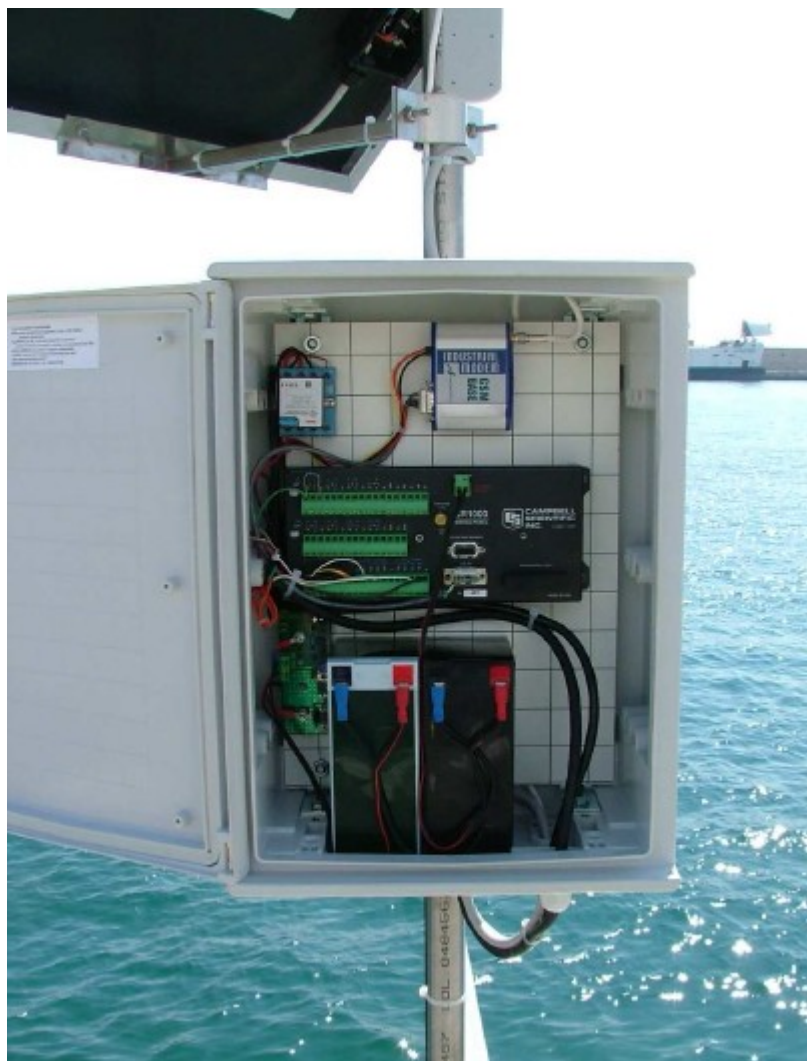
Fig. 5.3.1-3: Vista del contenitore apparati al cui interno sono visibili l'acquisitore dati CR1000, il modem GSM, le batterie ed il regolatore di carica.
